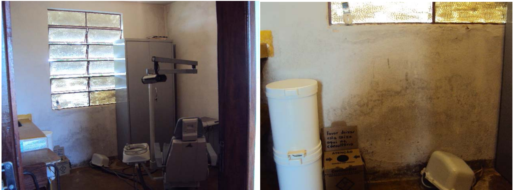
Instalações precárias de unidade básica de saúde.
